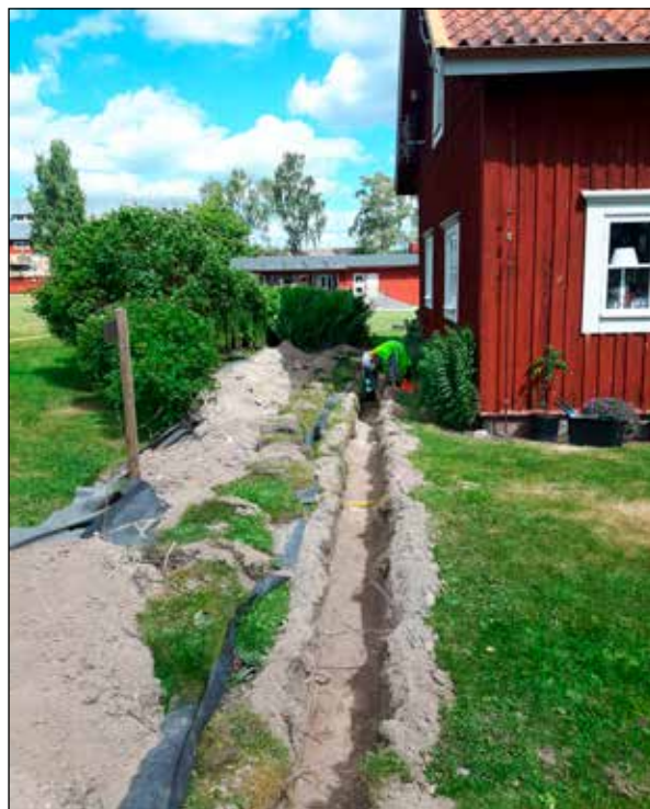
Figur 4: Kabelschaktet grävdes enligt plan intill vaktmästarbostadens västliga vägg och mot söder. Kabelschaktet var cirka 0,4 meter brett och i snitt 0,4 meter djupt. Daniel Gunnarsson rensar schaktprofilen. Foto mot norr.
